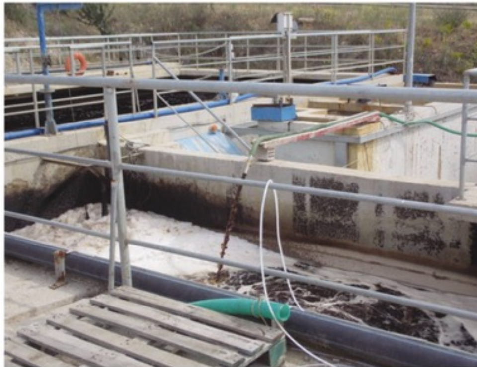
Σχήμα 10.12 Εισροή διασταλαζόντων στη μονάδα συλλογής και επεξεργασίας στη Μαυροράχη. Το χρώμα είναι ενδεικτικό του υψηλού οργανικού φορτίου.
