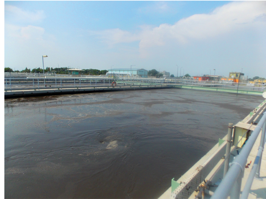
Δεξαμενή αερισμού ΜΕΥΑ Θεσσαλονίκης
