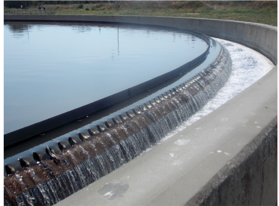
Δεξαμενή πρωτοβάθμιας καθίζησης ΜΕΥΑ Θεσσαλονίκης Διακρίνεται η υπερχειλίση των υγρών αποβλήτων
