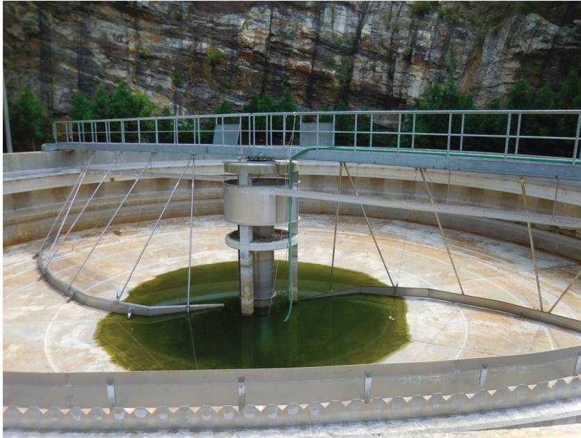
Δεξαμενή πρωτοβάθμιας καθίζησης ΜΕΥΑ Καβάλας
