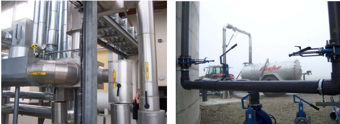
Σχήμα 7.15: Μονωμένες σωληνώσεις αερίου (αριστερά) και σωληνώσεις για το κομπόστ (δεξιά) (RUTZ, 2008)
