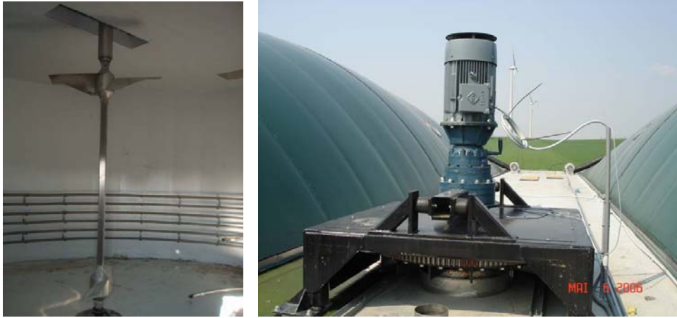
Σχήμα 7.21: Αναδευτήρες κρεμασμένων πτερυγίων (αριστερά) και η μηχανή ανάδευσης (δεξιά) (AGRINZ GmbH, 2006)
