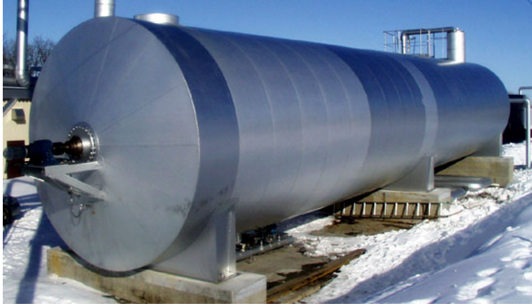
Σχήμα 4.3: Οριζόντιος χωνευτήρας, κατασκευασμένος στην Δανία (Nordisk Folkecenter, 2001)
