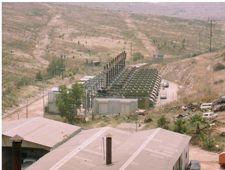
Σχήμα 4.14: Έργο εκμετάλλευσης του βιοαερίου στη χωματερή των Άνω Λιοσίων, Αθήνα, Ελλάδα (ΣΙΟΥΛΑΣ, 2005)
