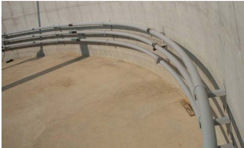
Σχήμα 7.17: Σωληνώσεις θέρμανσης εγκατεστημένες στον χωνευτήρα (AGRINZ GmbH, 2008)
