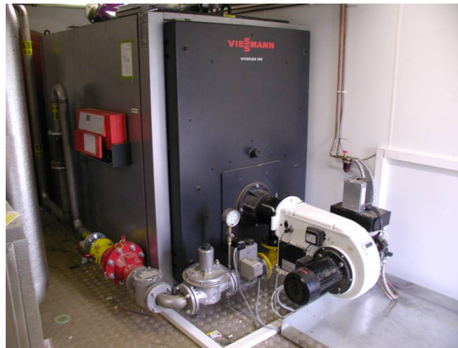
Σχήμα 5.2: Καυστήρας βιοαερίου για παραγωγή θερμότητας (AGRINZ GmbH, 2008)
