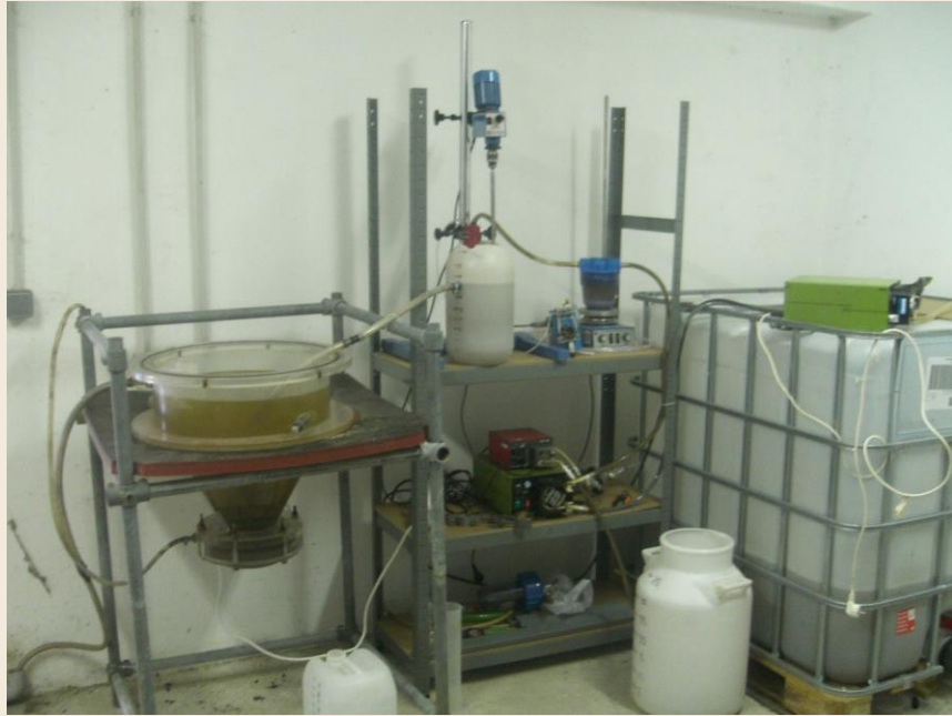
Μονάδα χημικής κατακρήμνισης
