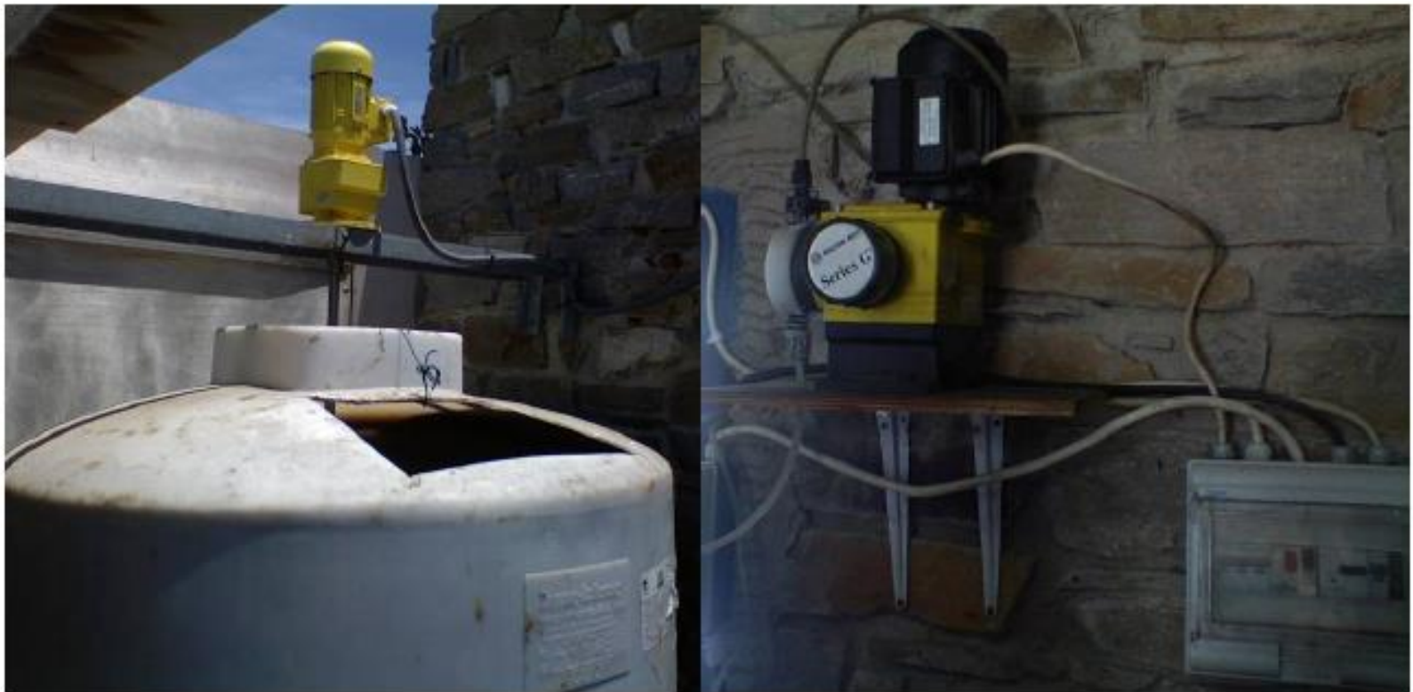
Εικόνα 3.17 Η δεξαμενή του διαλύματος νιτρικής αμμωνίας και η δοσομετρική αντλία.
