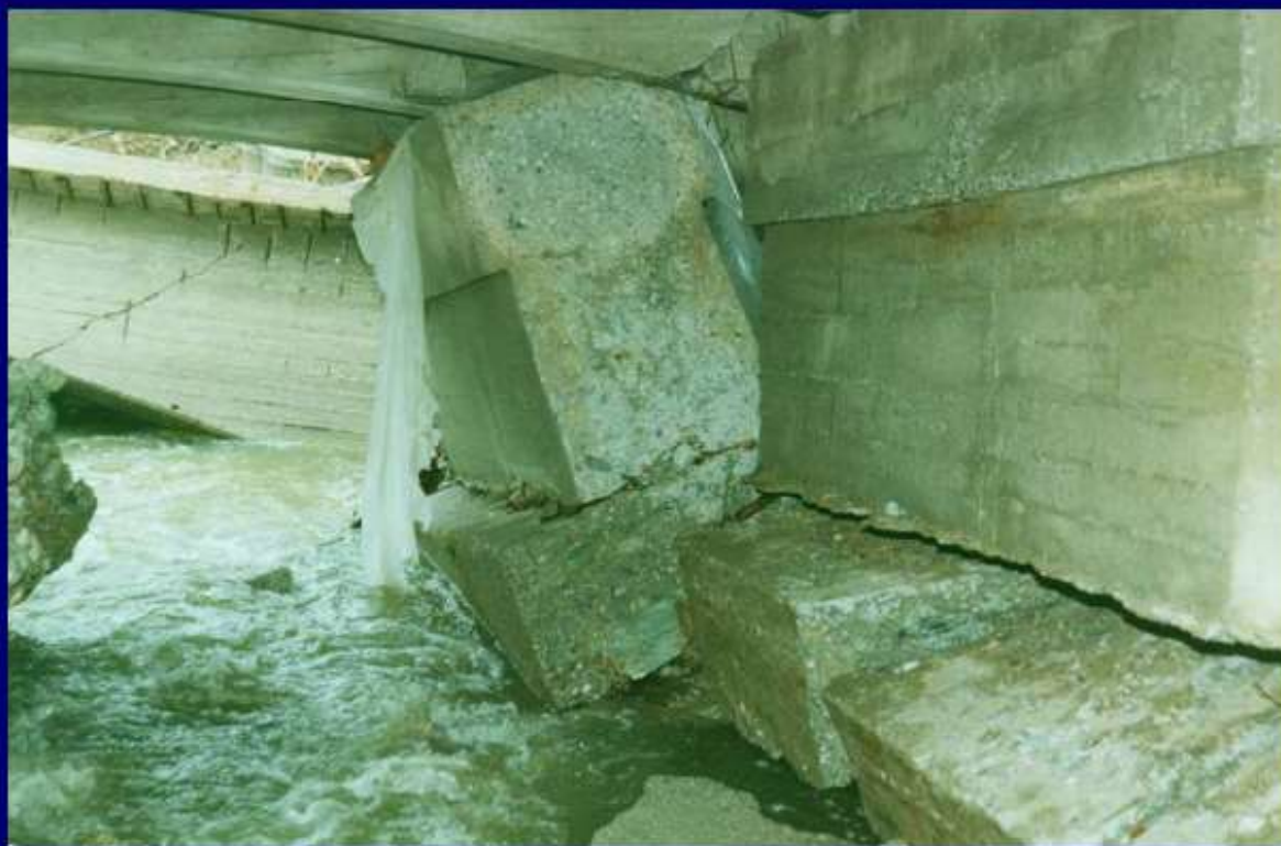
Μετατόπιση μεσοβάθρου γέφυρας στο χείμαρρο Ζηλιάνα λόγω υποσκαφής
