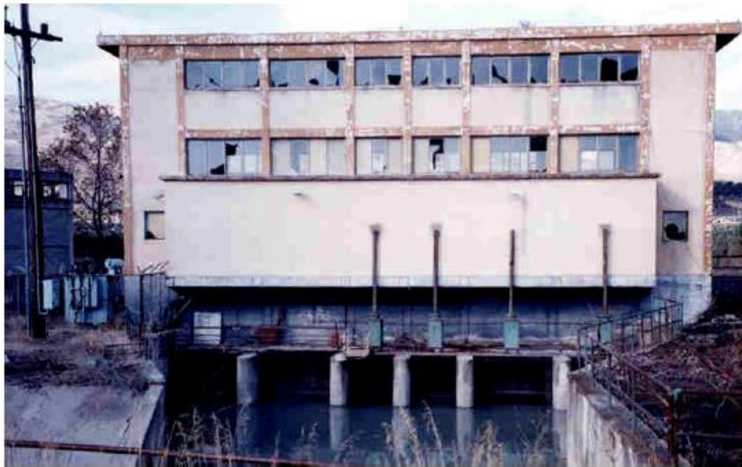
Σχ. 2 Χαρακτηριστική εικόνα που προδίδει μειωμένη φροντίδα και συντήρηση ενός αντλιοστασίου στην περιοχή των εγγειοβελτιωτικών έργων του Κάτω Αχελώου.
