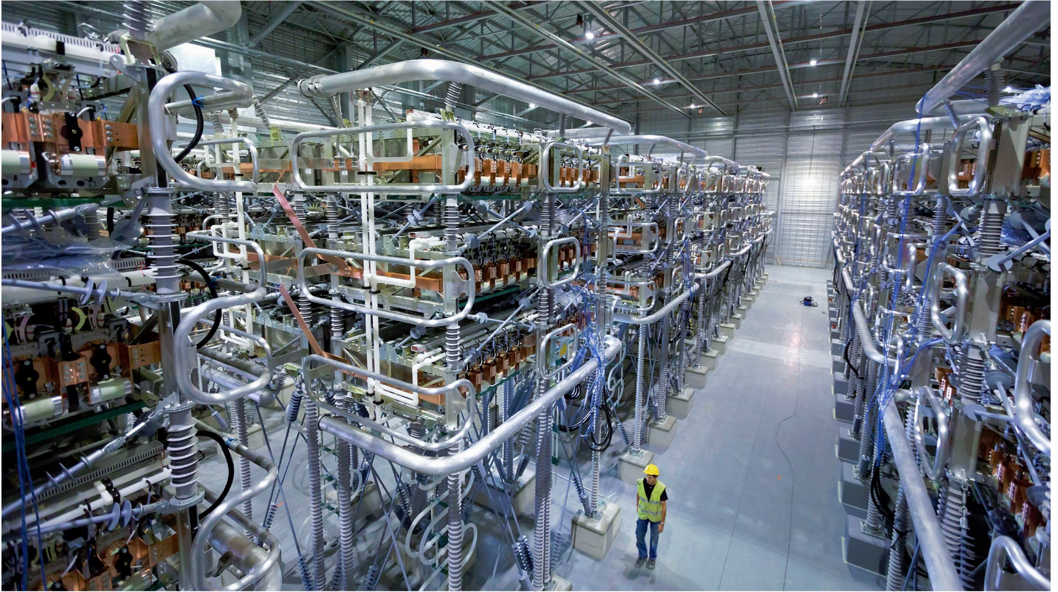
HVDC Plus IGBT converter modules, Siemens AG
