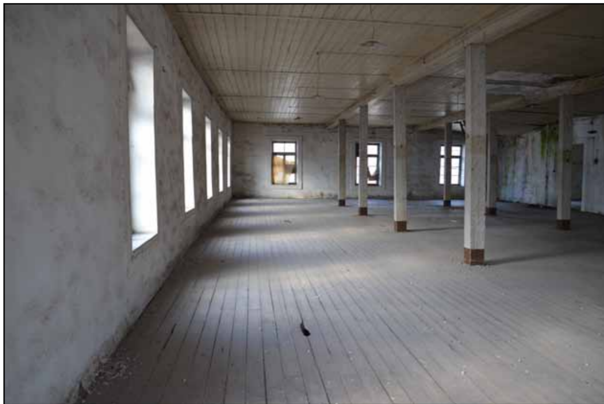
Απαραίτητη συνθήκη στην εργασία αποτελεί η εξασφάλιση ομοιόμορφου και ικανοποιητικού φωτισμού. Απόψεις από σαλόνια εργασίας του τρίτου ορόφου όπου τα ανοίγματα είναι μεγαλύτερων διαστάσεων από τα υποκείμενα.
