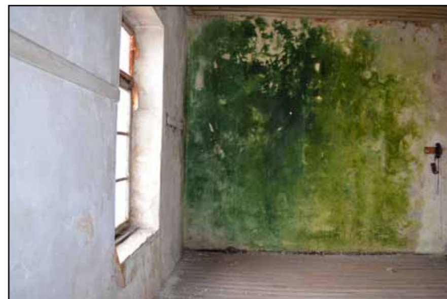
Φθορές στον μεσότοιχο από τα όμβρια [βόρειο σύστημα]
