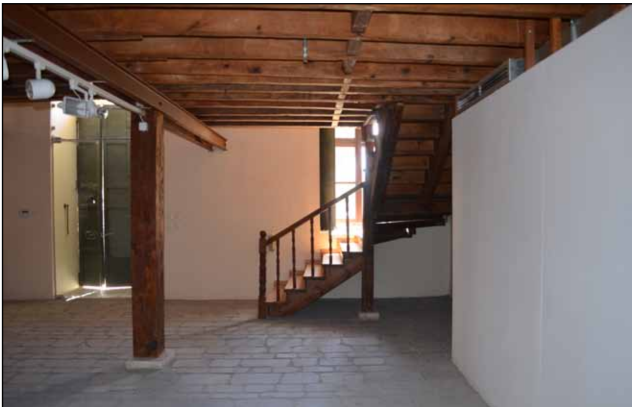
Δημοτική καπναποθήκη - η σκάλα από το ισόγειο στον πρώτο. Αρθώνεται με τρεις κεκλιμένες ξύλινες δοκοί που συνιστούν τη βαθμιδοφόρο τους [φωτο 2014]
