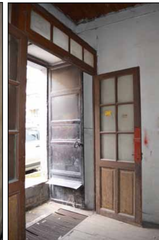
Πρόσθετη ξυλοκατασκευή στην είσοδο
