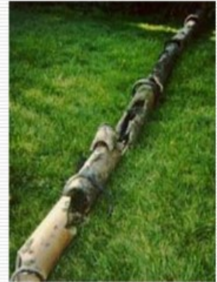
Διαβρωμένος αγωγός αποχέτευσης
