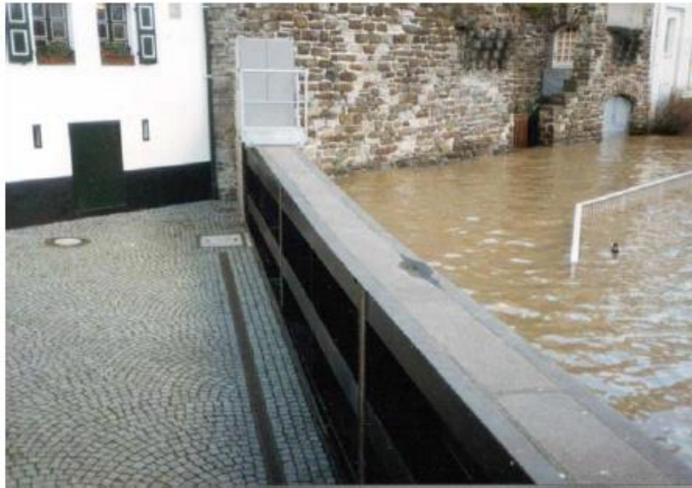
Κατασκευαστικά μέτρα Θυροφράγματα για πλημμυρικά νερά
