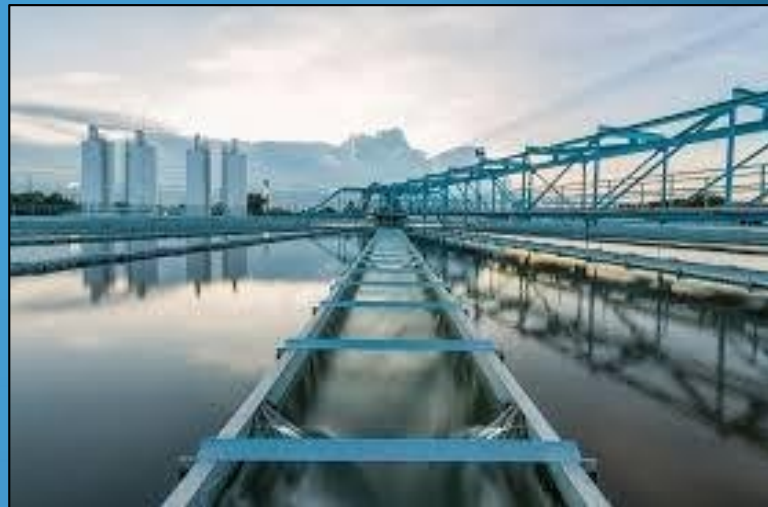
Επεξεργασία Βιομηχανικού νερού
