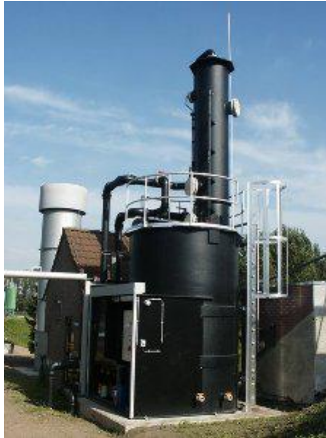
Μονάδα επεξεργασίας αέρα για απομάκρυνση υδρόθειου.
