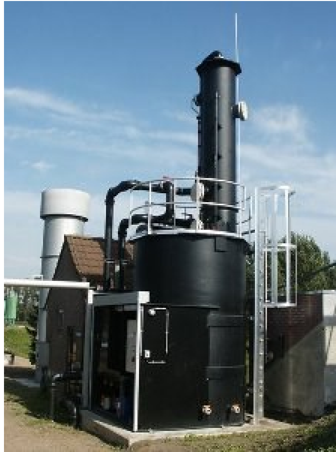
Μονάδα επεξεργασίας αέρα για απομάκρυνση υδρόθειου.
