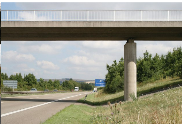
Βάθρα που έχουν υπολογιστεί έναντι πρόσκρουσης οχημάτων ⇒ Κατηγορία κινδύνου 3
