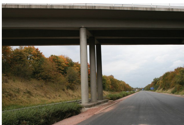
Βάθρα που δεν έχουν υπολογιστεί έναντι πρόσκρουσης οχημάτων – Κίνδυνος κατάρρευσης φερόντων στοιχείων ⇒ Κατηγορία κινδύνου 1
