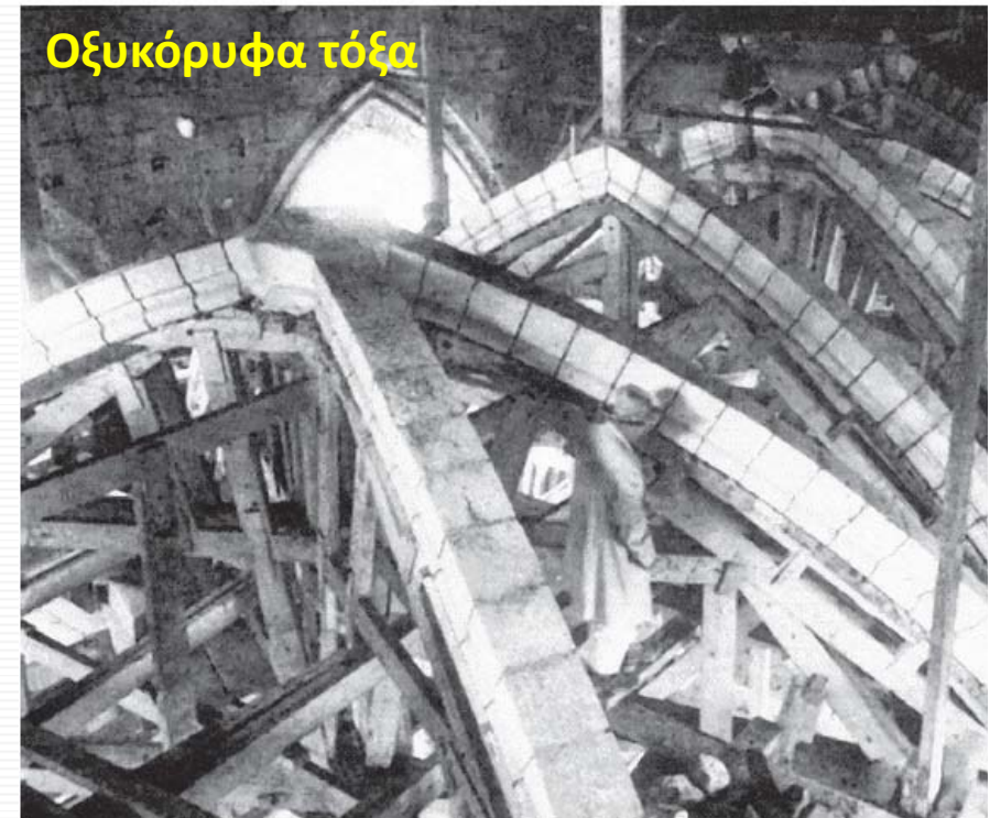
εικ. 8 Αποκατάσταση των τόξων σταυροθολίων στον καθεδρικό ναό της Solssons (Γαλλία), μετά αι τον Α΄ παγκόσμιο πόλεμο.
