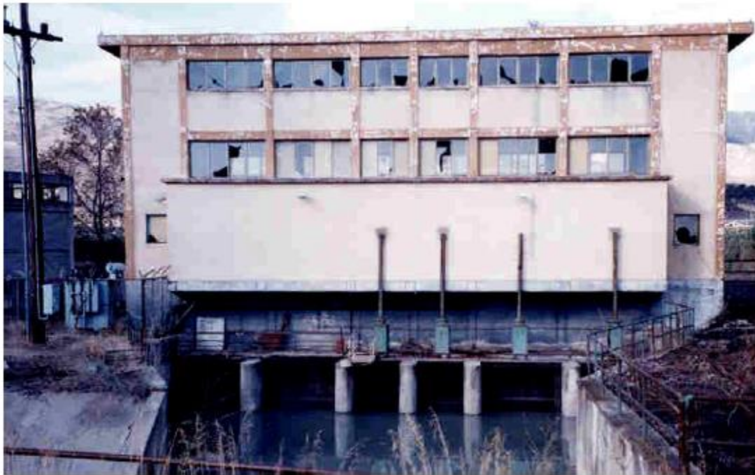
Σχ. 2 Χαρακτηριστική εικόνα που προδίδει μειωμένη φροντίδα και συντήρηση ενός αντλιοστασίου στην περιοχή των εγγειοβελτιωτικών έργων του Κάτω Αχελώου.
