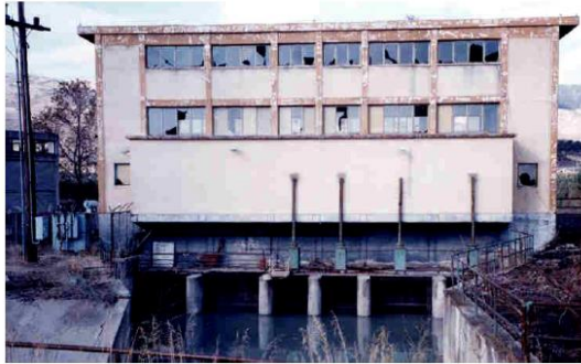
Σχ. 2 Χαρακτηριστική εικόνα που προδίδει μειωμένη φροντίδα και συντήρηση ενός αντλιοστασίου στην περιοχή των εγχειριστικών έργων του Κάτω Αχελώου.
