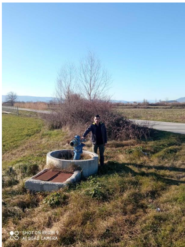
Εικόνα 3-10: Υδροληψία (υδροστόμιο) δικτύου περιοχής Πόρου
