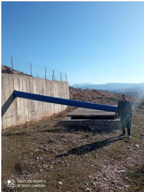
Εικόνα 3-25: αγωγός υπερχείλισης δεξαμενής Π1
