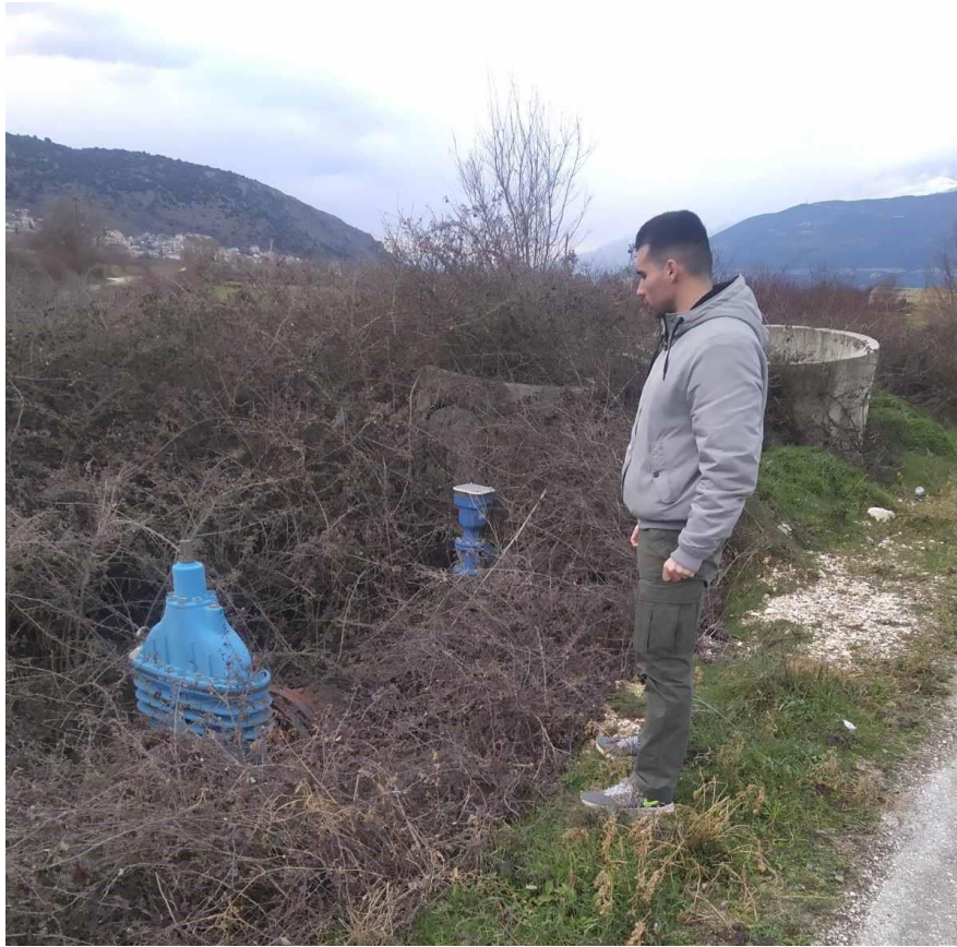
Εικόνα 3-11: Υδραυλική βαλβίδα ελέγχου και αερεξαγωγός δικτύου περιοχής Πόρου
