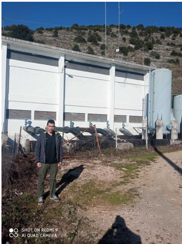
Εικόνα 3-28: Στα αντλιοστάσια Α1 και Α2 της περιοχής Πόρου
