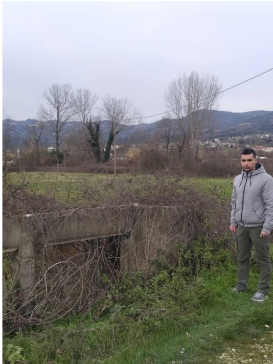
Εικόνα 3-4: Καναλέτο παλιού αρδευτικού δικτύου που παρέμεινε μετά την αποξήλωση του προγενέστερου έργου με ειδικό φρεάτιο συλλεκτήρα για την άρδευση αγροτεμαχίου μικρότερου υψομέτρου από το καναλέτο
