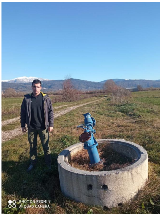
Εικόνα 3-9: Υδροληψία (υδροστόμιο) δικτύου περιοχής Πόρου
