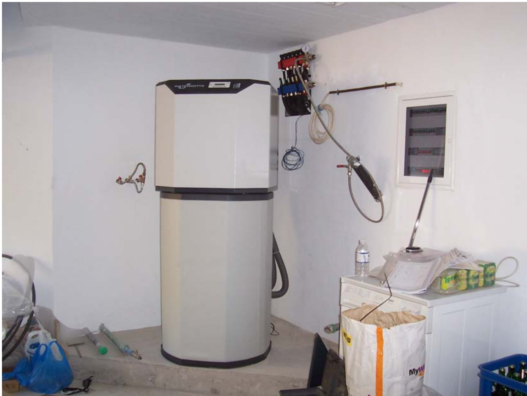
Πάνω: Ανάπτυξη οριζόντιου κυκλώματος γεωεναλλάκτη για εγκατάσταση συστήματος γεωθερμικής αντλίας θερμότητας σε μικρή κατοικία στη Σκόπελο. Κάτω: Η αντλία θερμότητας που τοποθετήθηκε για την κάλυψη των αναγκών θέρμανσης και ψύξης αυτής της κατοικίας. Είναι χαρακτηριστικός ο μικρός όγκος που καταλαμβάνει.
