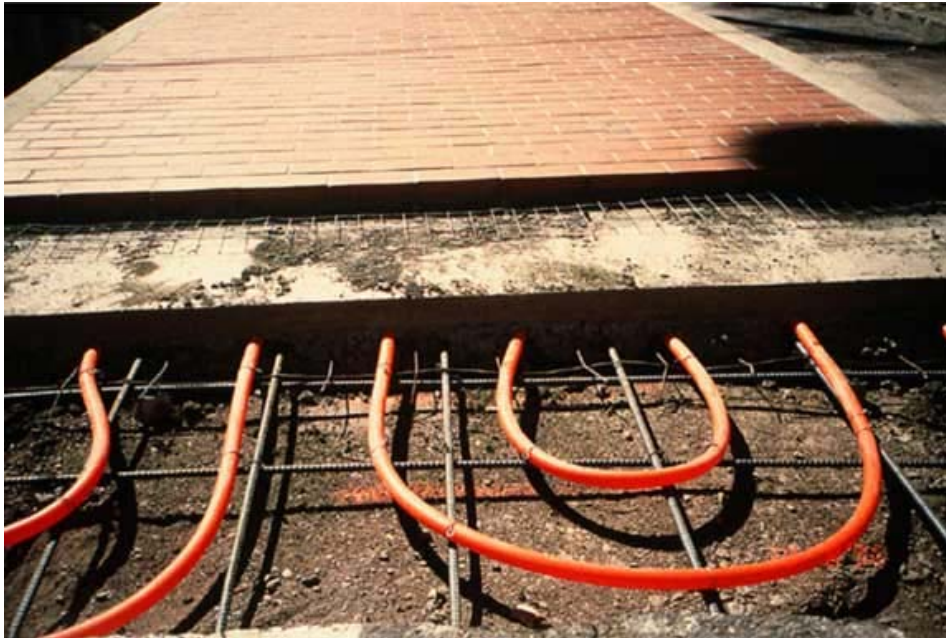
Σωλήνες γεωθερμικού νερού μπορούν να τοποθετηθούν κάτω από πεζοδρόμια και δρόμους για αντιπαγετική προστασία κατά τη διάρκεια του χειμώνα, όπως σ' αυτό το πεζοδρόμιο στο Klamath Falls (Oregon, Η.Π.Α.). [Πηγή: Geothermal Education Office, www.geothermal.marin.org ]
