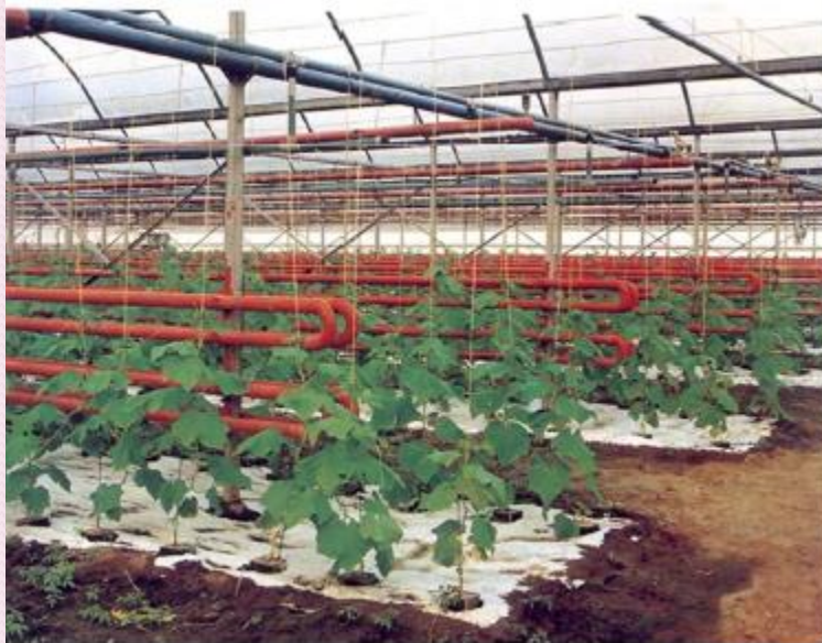
Εναέριες σωλήνες θέρμανσης
