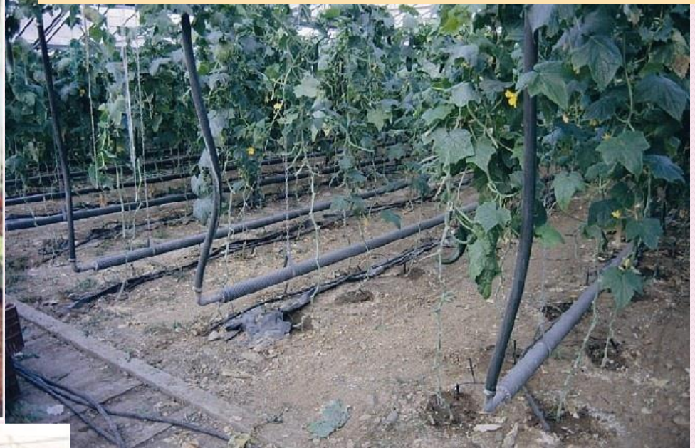
Θέρμανση με μεταλλικούς αγωγούς με πτερύγια
