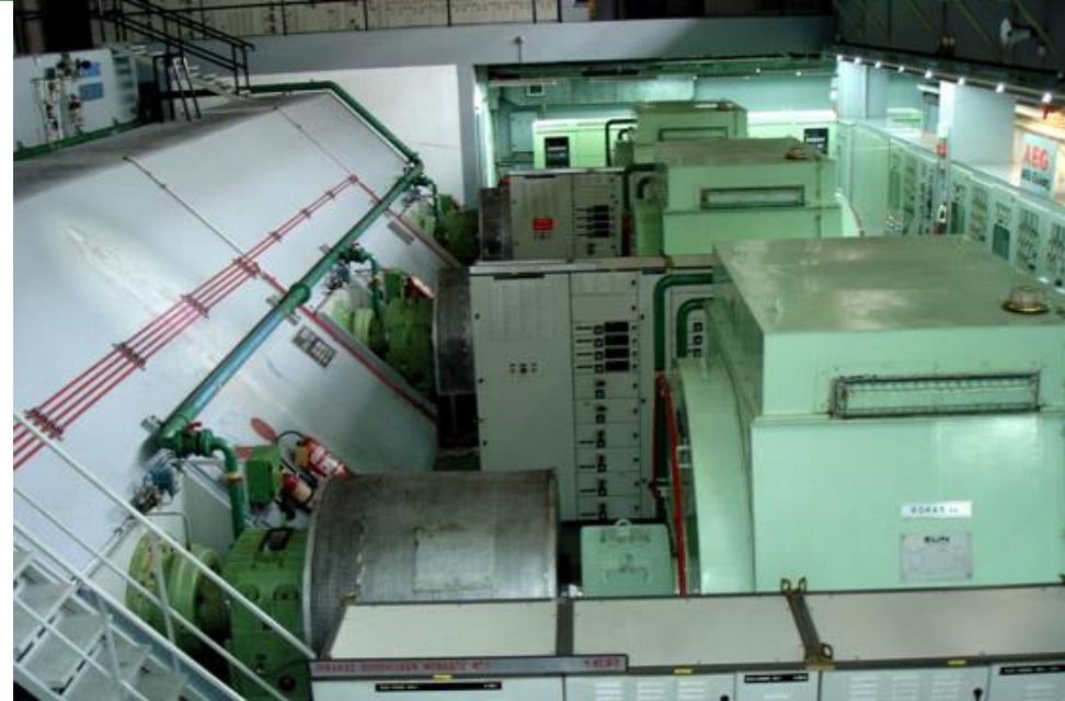
ΥΗΣ Μακροχωρίου, Βέροια, Μακεδονία. 3 μονάδες συνολικής ισχύος 10,8 MW
