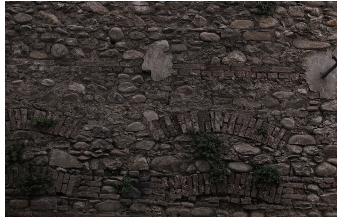
Εγ3. 4 Λιθοδομή ανατολικής όψης. Η φθορά έχει εμφανίσει τις ενισχυμένες ζώνες και τις θέσεις των ξυλοδεσιών που κρύβονται πίσω από ζώνες οπτοπλίνθων.
