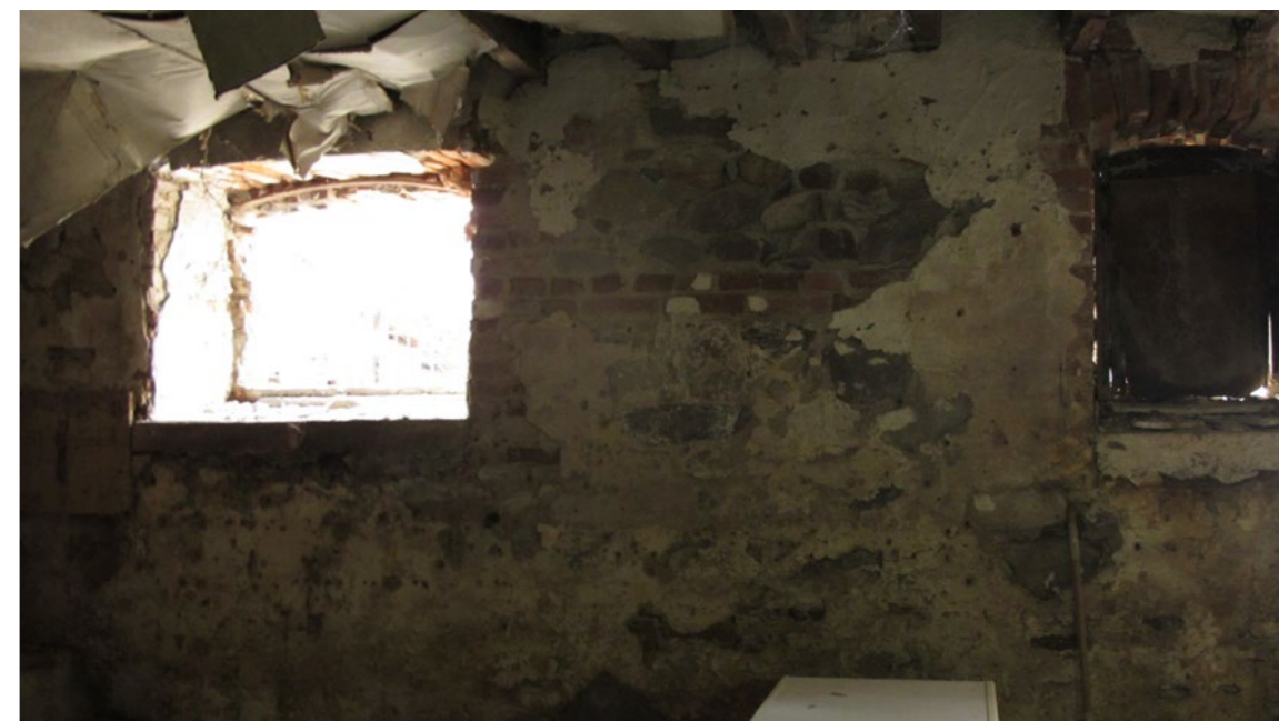
Εγ4. 9 Υπόγειος χώρος κτηρίου Α. Ανερχόμενη υγρασία, αποκόλληση επιχρίσματος, απώλεια κουφωμάτων.
