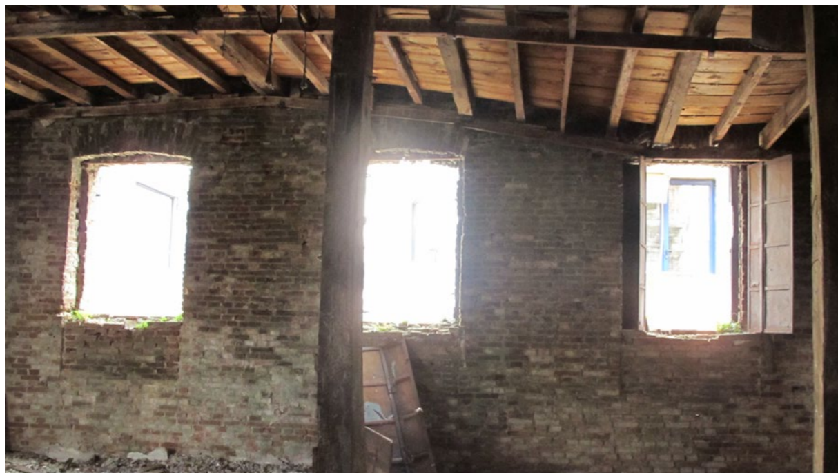
Εγ4. 1 Καθίζηση στην ανατολική πλευρά της καθιστής στέγης του κτηρίου Α.
