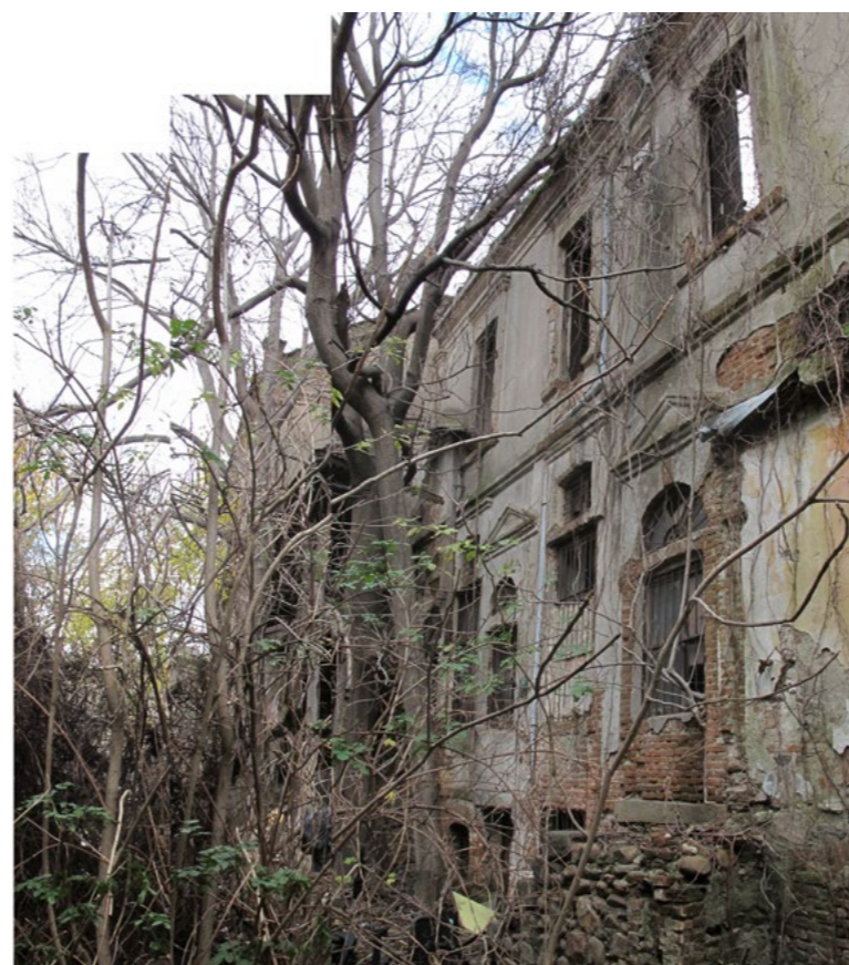
Επι. 5 Κρυμμένη εσωτερική όψη της καπναποθήκης Ζωΐδη εντός του οικοδομικού τετραγώνου Ο.Τ. 252. Δυτική όψη κτηρίων Α&Β.
