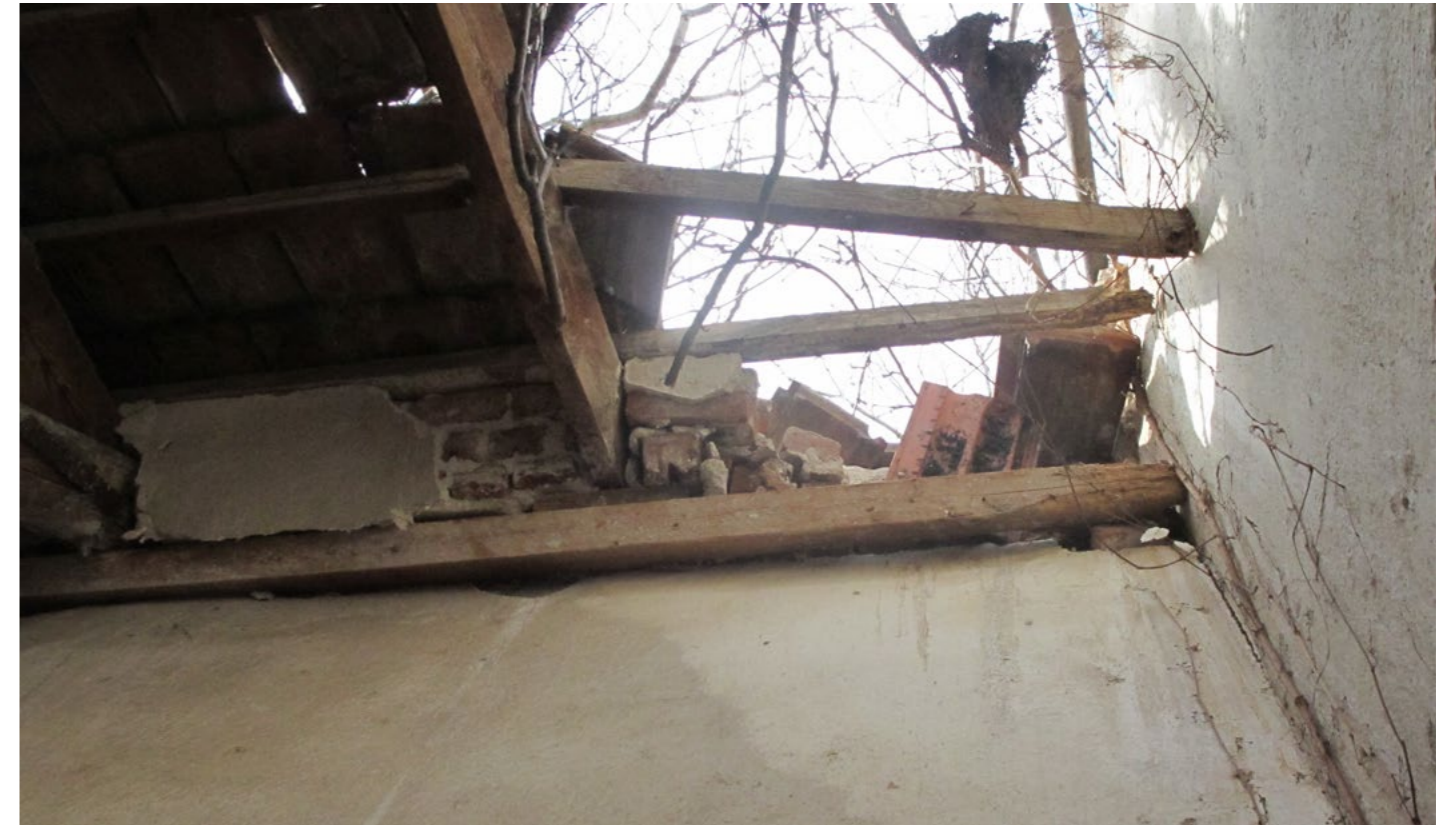
Εγ4. 11 Κατάρρευση δίριχτης κρεμαστής στέγης σε κτήριο Β. Αλλοίωση εξωτερικής τοιχοποιίας που έχει συμπαρασυρθεί κατά την πτώση.
