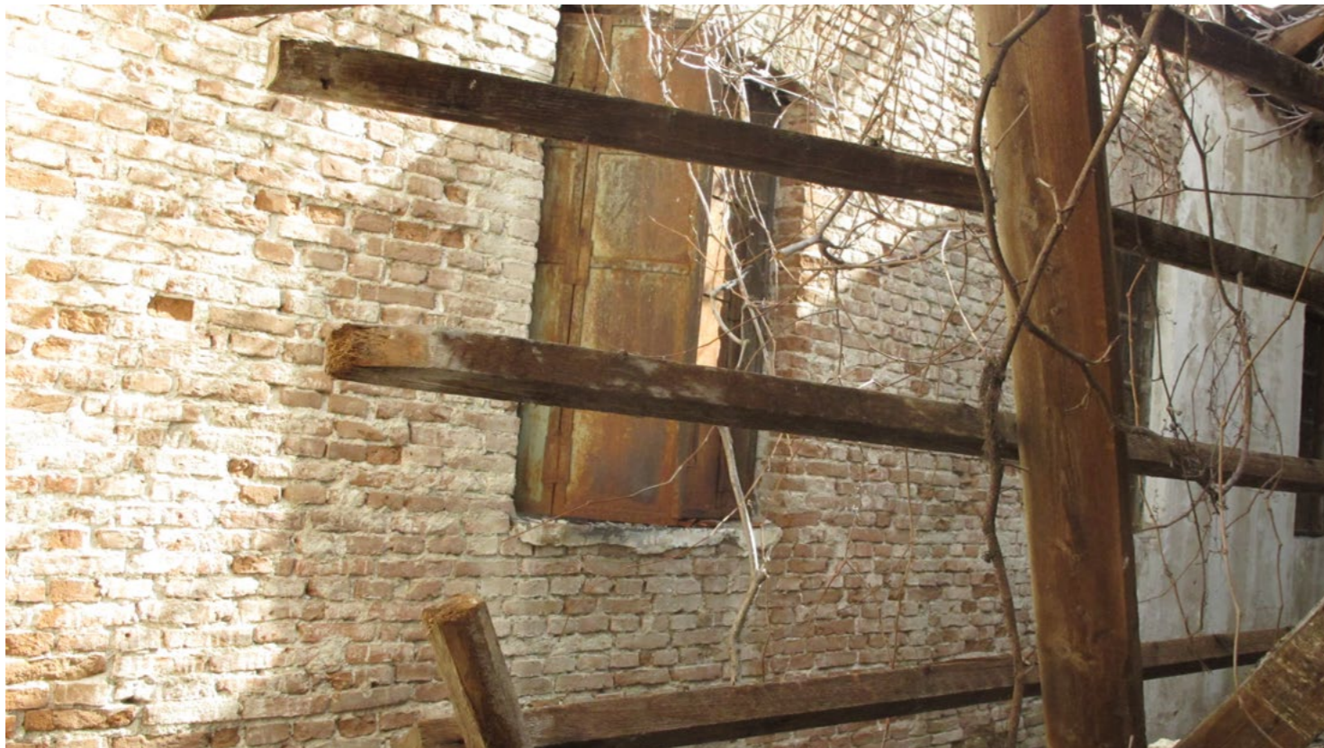
Εγ4. 12 Κατάρρευση δίριχτης κρεμαστής στέγης σε κτήριο Β. Ολική αποκόλληση επιχρίσματος στο ασκεπές τμήμα του ορόφου Β.
