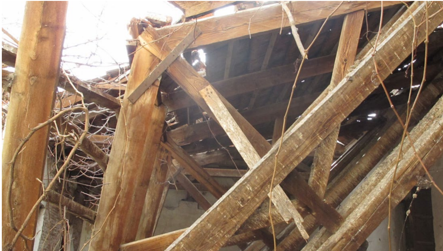
Εγ4. 10 Κατάρρευση δίριχτης κρεμαστής στέγης σε κτήριο Β.
