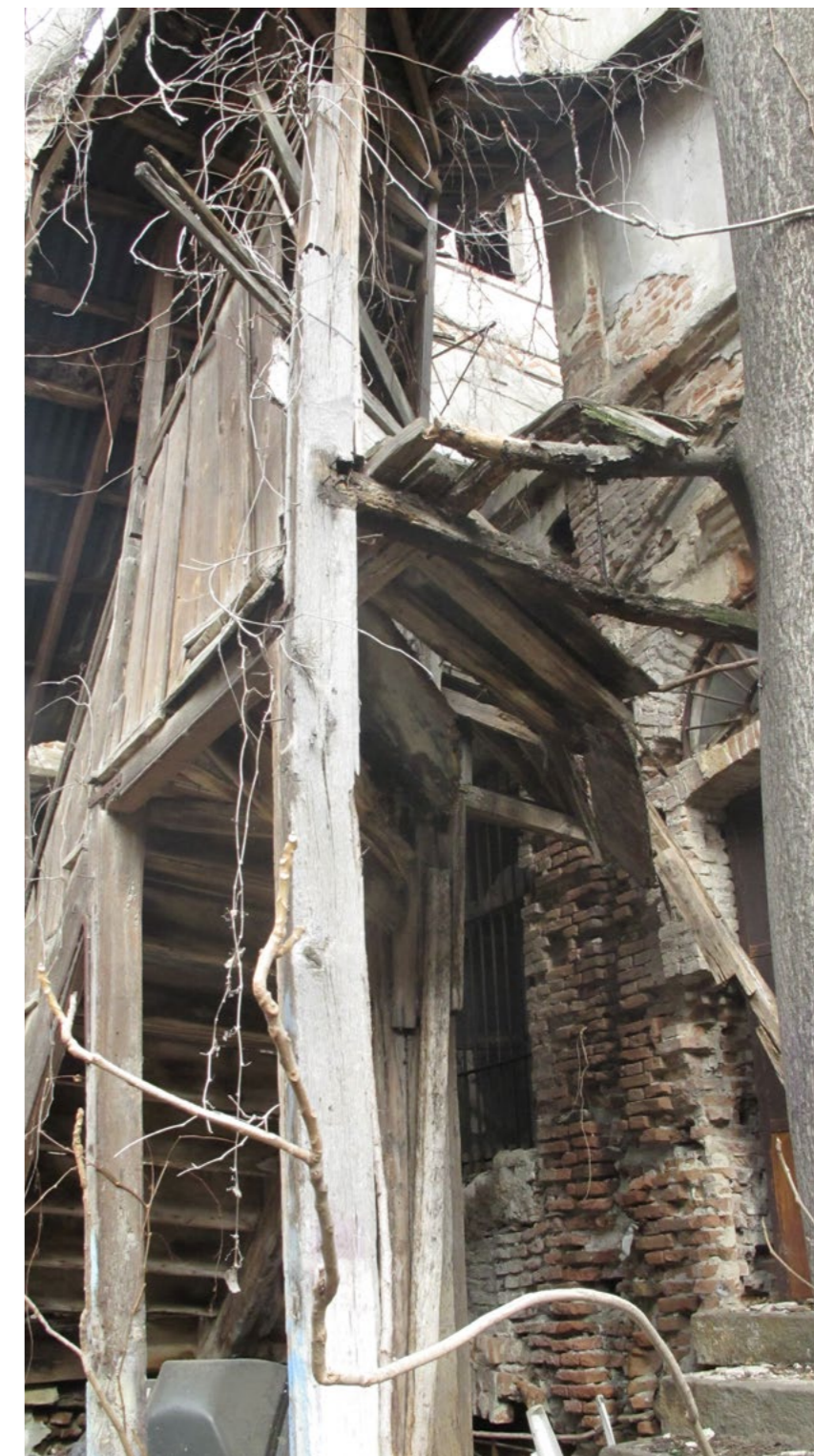
Εγ4. 3 Είσοδος κτηρίου Β. Η κατάρρευση της εξωτερικής ξύλινης σκάλας.
