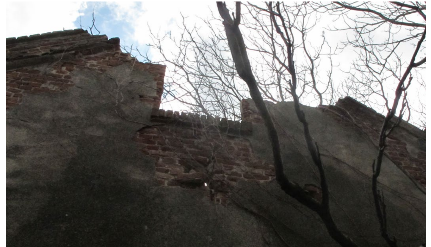
Εγ4. 13 Απώλεια της τελικής δίριχτης κορυφογραμμής του κτηρίου Β στο σημείο της κατάρρευσης της στέγης.
