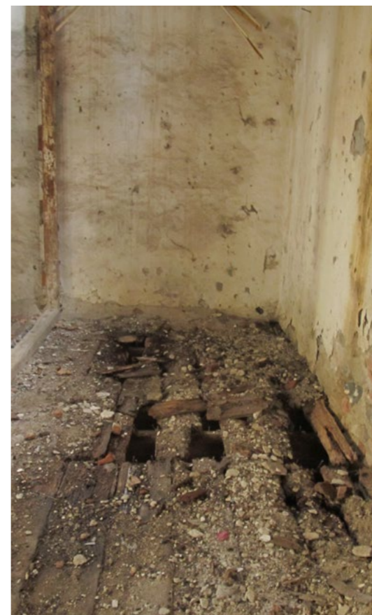
Εγ4. 5 Εσωτερική φθορά κτήριο Α, ισόγειο. Διαβρωμένα ξύλινα στοιχεία.
