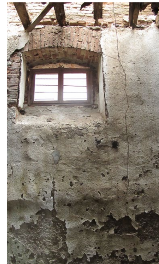
Εγ4. 6 Εσωτερική φθορά κτήριο Β ισόγειο. Διαβρωμένα ξύλινα στοιχεία ορόφου μετά την κατάρρευση της στέγης. Αποκόλληση επιχρισμάτων από κατερχόμενη υγρασία.
