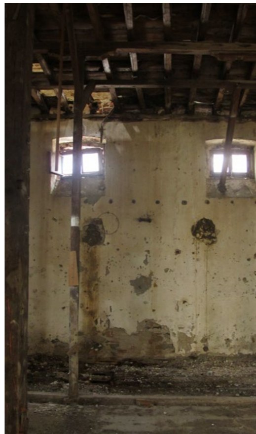
Εγ4. 4 Εσωτερική φθορά κτήριο Α, ισόγειο.
