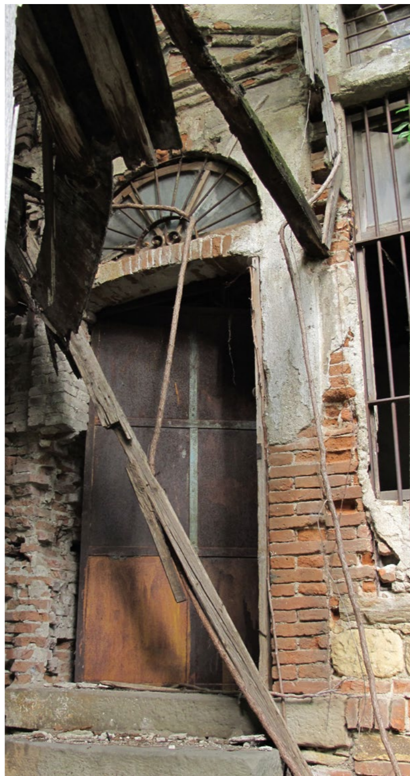
Εγ4. 2 Είσοδος κτηρίου Β. Το πλατύσκαλο της εξωτερικής ξύλινης σκάλας έχει καταρρεύσει. Η μεταλλική πόρτα έχει οξειδωθεί πλήρως. Το εξωτερικό επίχρισμα έχει απομακρυνθεί εμφανίζοντας την οπτοπλινθοδομή που με την σειρά της έχει αποσαθρωθεί.
