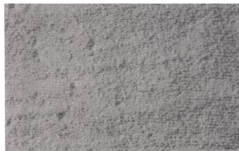
Εικόνα 13. Διάβρωση με βελονισμούς, ζαχαροειδής φθορά. 1
