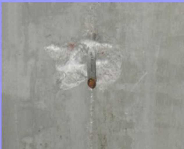
Προεξέχουσα φουρκέτα σε τοίχωμα υπογείου. (πηγή: http://www.arch.ntua.gr/sites/default/files/resource/7846_/06_katotero_patoma.pdf )
